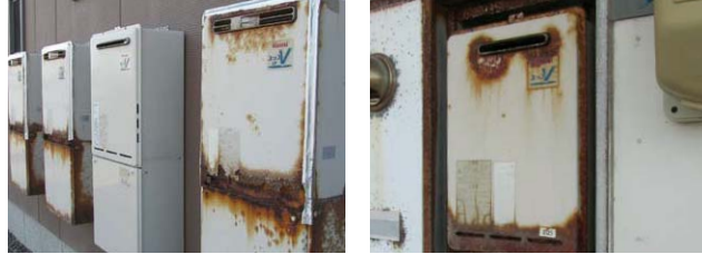
塩害により腐食したガス給湯器
